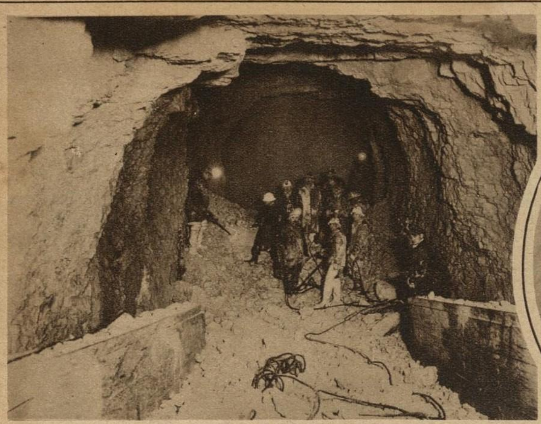
VISTA DEL TUNEL DE VEINTE KILOMETROS de largo, que llevará el agua del Lago Michigán a los filtros construídos para abastecer de agua potable a la ciudad de Chicago.
